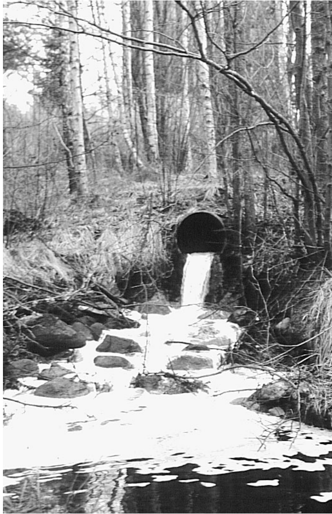
Avloppsrör som mynnar rakt i vattendraget. Skummet visar att någonting inte står rätt till!
